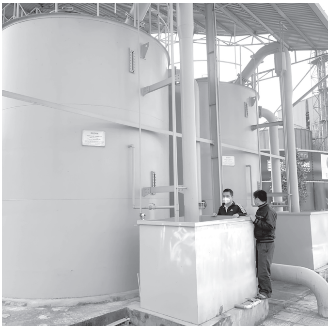
Nhân viên Công ty Cấp thoát nước Tuyên Quang kiểm tra định kỳ hệ thống xử lý nước sạch.
