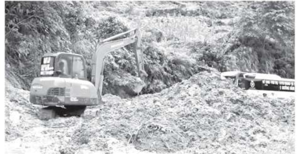
Lực lượng chức năng kịp thời huy động máy móc, khắc phục điểm sạt, lở trên tuyến Tỉnh lộ 177.
