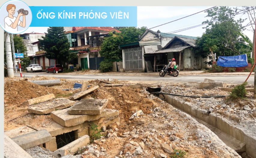
Tuyến đường ven sông Lô, thuộc thôn Bắc Mực, xã Hàm Yên, đơn vị thi công không lắp đặt rào chắn, tiềm ẩn nhiều nguy cơ cho người tham gia giao thông.
