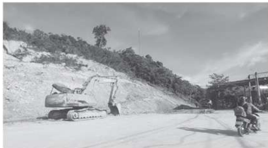
Tuyến đường Quốc lộ 2C đoạn qua xã Kim Bình đang được đơn vị thi công san gạt đất đá sạt lở để đảm bảo an toàn cho người tham gia giao thông.
