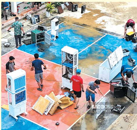
Nhiều thiết bị điện của Trường PTDTBT THCS Chiềng Sơ, xã Mường Luân đã được sửa.
