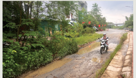
Đoạn đường đầu tư dở dang khiến việc đi lại của người dân rất khó khăn.
