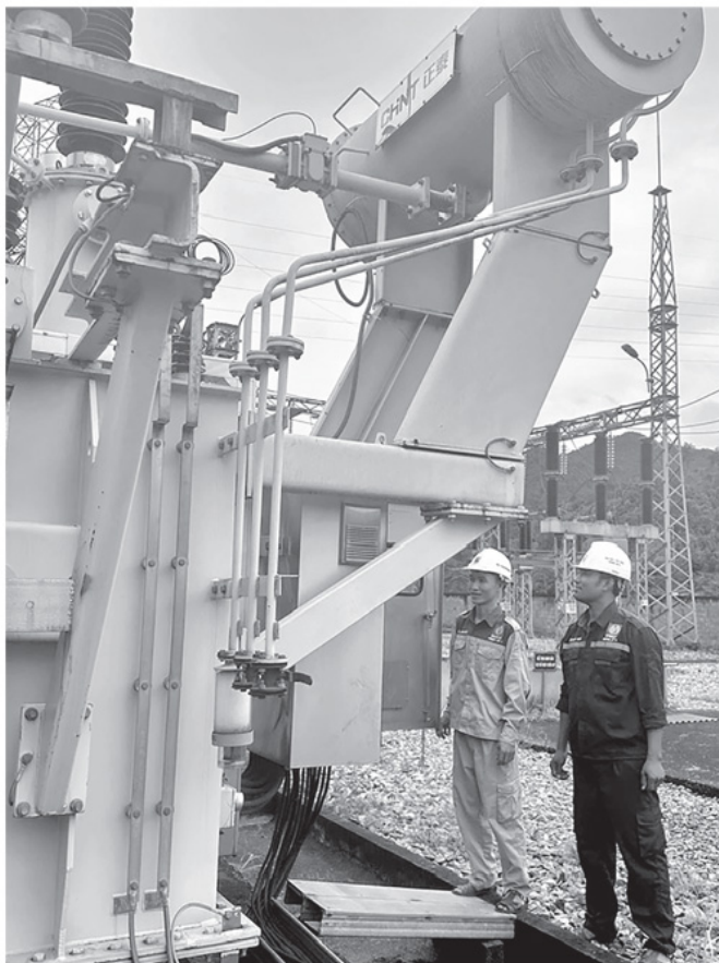
Đội ngũ kỹ sư Nhà máy thủy điện Sông Lô 2, luôn chủ động kiểm tra hệ thống thiết bị, trạm biến áp, đảm bảo phát điện ổn định, phục vụ phát triển kinh tế, xã hội của tỉnh.
