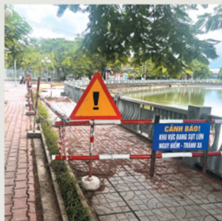
Điểm sụt lún chưa được khắc phục.
