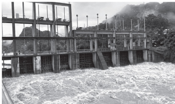
Nhà máy Thủy điện Sông Miện 6 mở 7 cửa xả lũ.
