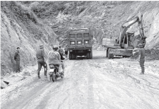
Khắc phục sạt lở Quốc lộ 279 đoạn qua xã Quang Bình.
