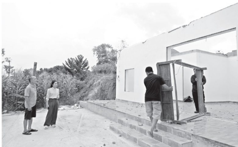
Người dân xã Yên Sơn tự nguyện tháo dỡ nhà cửa xây dựng trái phép.
