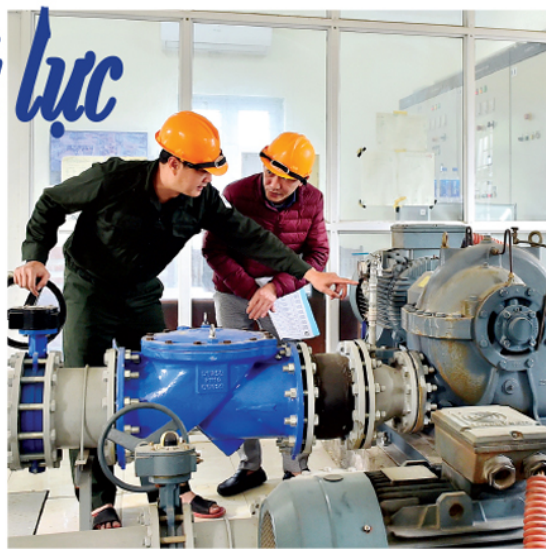
Công nhân vận hành hệ thống cấp nước khu vực phường Minh Xuân.
