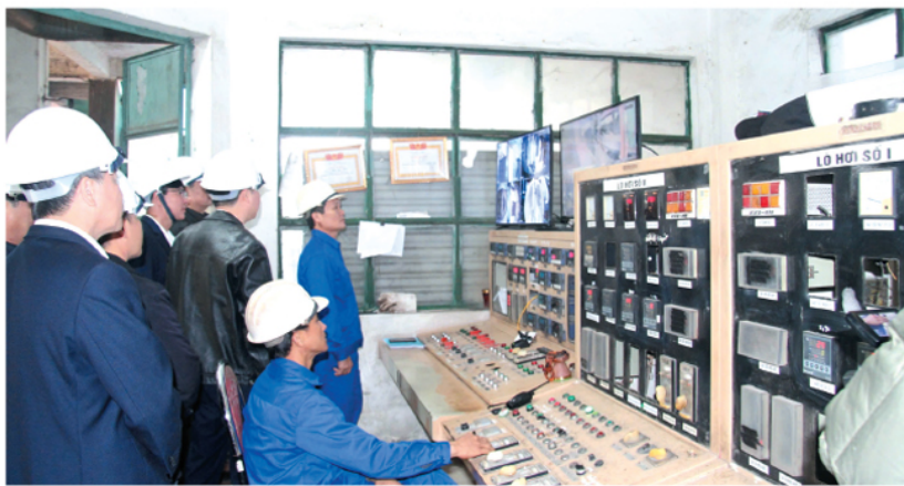
Dây chuyền ép mía của Công ty Cổ phần Mía đường Sơn Dương được vận hành bằng công nghệ số.
