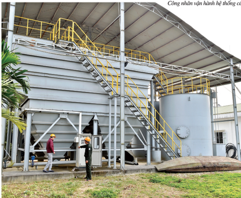
Trạm xử lý nước mặt tại phường Minh Xuân của Công ty Cổ phần Cấp thoát nước Tuyên Quang.
