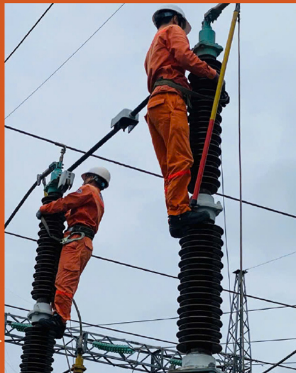
Công nhân công ty kiểm tra, bảo dưỡng thiết bị bảo đảm vận hành an toàn.
