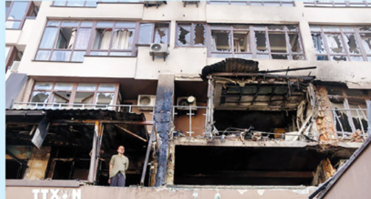
Một tòa nhà bị hư hỏng tại quận Shevchenkivskiy ở Thủ đô Kiev, Ukraine.
