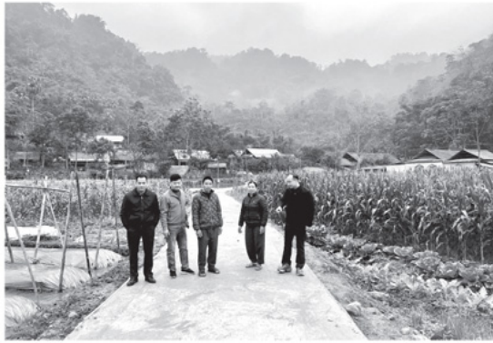
Tuyến đường nội đồng thôn Bản Ho, xã Kiên Đài được bê tông hóa, thuận tiện cho việc đi lại của người dân.
