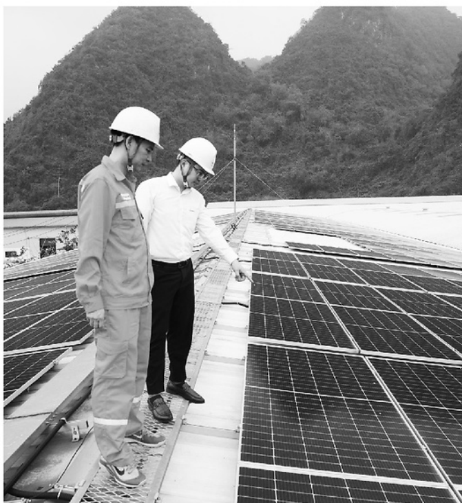
Điện mặt trời mái nhà được lắp đặt tại Công ty TNHH MTV Bao bì DHT.
