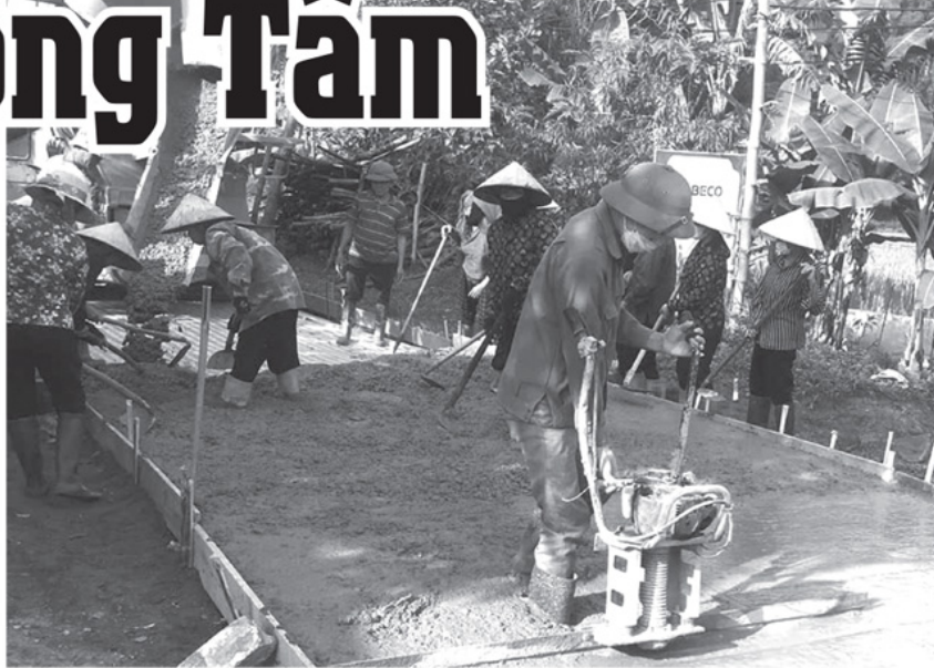
Người dân xã Đồng Tâm góp công làm đường giao thông nông thôn, hoàn thiện hạ tầng phục vụ đời sống và sản xuất.
