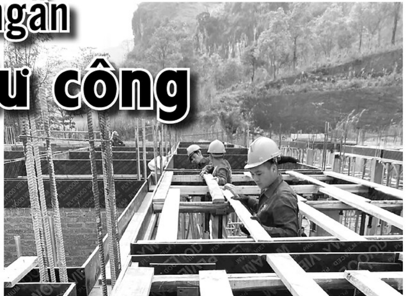
Công nhân Công ty Cổ phần Đầu tư và Phát triển Phương Đông tập trung thi công xuyên ngày lễ.
