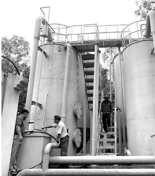
Công trình nước sạch nông thôn xã Nhữ Hán cung cấp nguồn nước sạch ổn định cho người dân.
