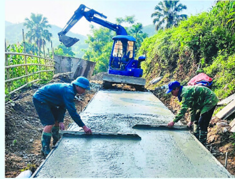
Thi công tuyến đường bê tông nông thôn tại thôn Ngọc Bình.
