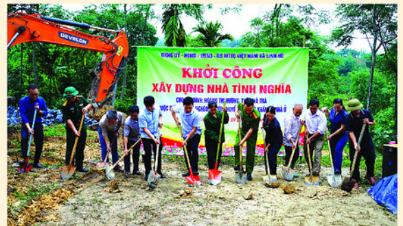
Đảng ủy, chính quyền xã Linh Hồ khởi công xây dựng nhà tình nghĩa cho gia đình bà Hoàng Thị Hương.
