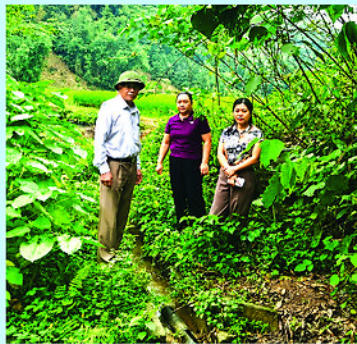
Thường trực HĐND xã Kiên Đài kiểm tra hệ thống mương xuống cấp.
