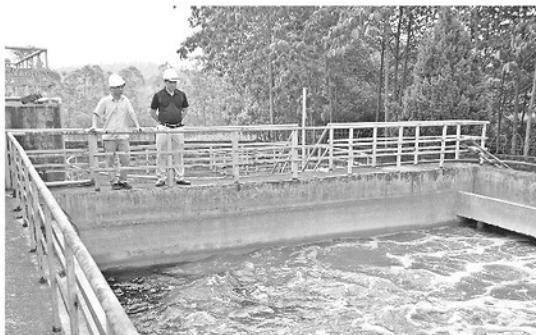
Hệ thống bể lắng nước xả thải của Nhà máy Đường Sơn Dương đáp ứng các yêu cầu về bảo vệ môi trường.
