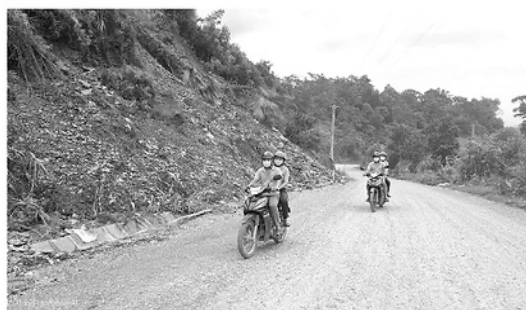
Điểm sạt lở trên tuyến đường ĐT 188 đoạn qua xã Bình An.
