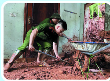
Khắc phục sạt lở khu vực Đèo Oai tại Km115, Quốc lộ 2C đoạn qua địa phận xã Trung Sơn.
