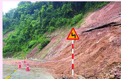
Sạt lở ta-luy đường tại phường Nguyễn Trãi, thành phố Hải Phòng.
