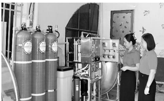
Hệ thống lọc nước tại Trường Mầm non Hoa Hồng, phường Hà Giang 2 phục vụ nhu cầu sử dụng nước hằng ngày của trẻ và công tác chế biến, sinh hoạt tại trường.
