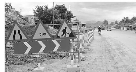
Không lắp biển báo công trình tại lối ra vào công trường sẽ bị phạt đến 20 triệu đồng (Ảnh minh họa).
