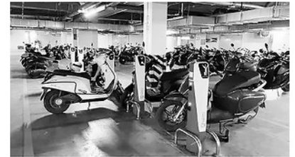
Khu vực sạc xe điện tại tầng hầm nhà để xe cần bảo đảm an toàn trong quá trình vận hành.
