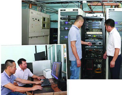
Cán bộ Trạm tiếp sóng phát thanh Cổng Trời kiểm tra thiết bị truyền dẫn.
